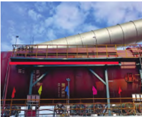
图 4 水泥回转窑筒体表面余热利用项目
